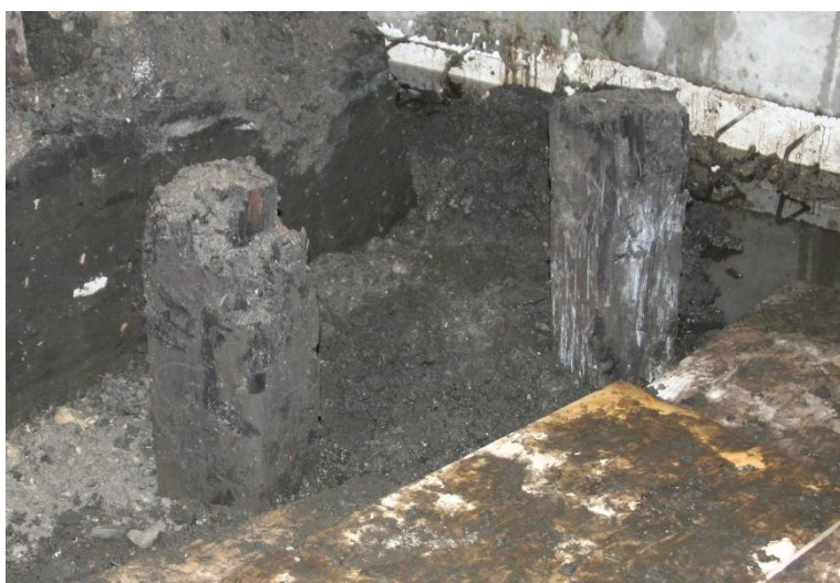
Figur 10. To piloteringspæle som de stod efter de blev gravet fri af det organiske opfyldslag som ses i baggrunden.
