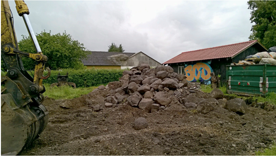
Figur 1. Ved standsningen af nedbrydningen af det gamle hus i 2017 var en stor del af ødekirkens fundamenter allerede opgravet.
