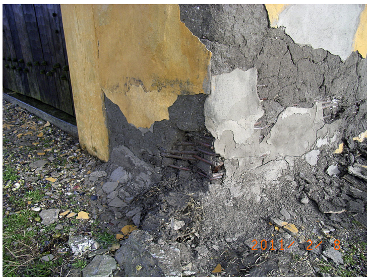
Hus med store afskalninger helt ind til pileflet. Det ses tydeligt, hvor der det foregående år har været lavet reparationer. På grund af væggenes dårlige forfatning opstår der konstant nye store områder med afskalninger.
